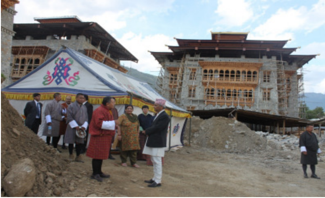
सम्माननीय प्रधान न्यायाधीश श्री खिलराज रेग्मी भुटानको सर्वोच्च अदालतको निर्माणाधीन भवन अवलोकनको क्रममा
